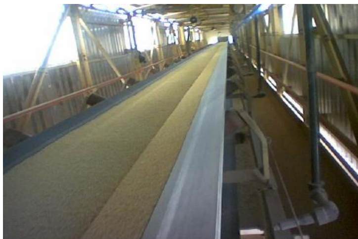
نمای داخلی از تسمه نقاله پوشیده جهت انتقال گوگرد
